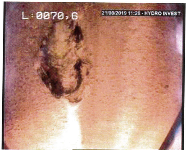
Photo N° 14 – Prof. = 70.6 m/rep Corrosion apparente sous forme de concrétion
