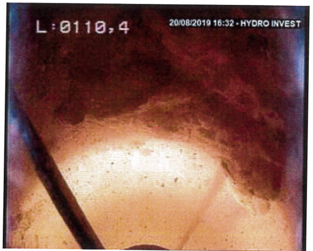
Photo N° 20 – Prof. = 110.4 m/rep Pustules de corrosion en relief
