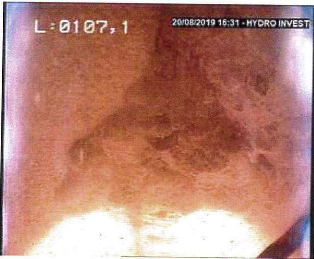
Photo N° 19 – Prof. = 107.1 m/rep Pustules de corrosion en relief
